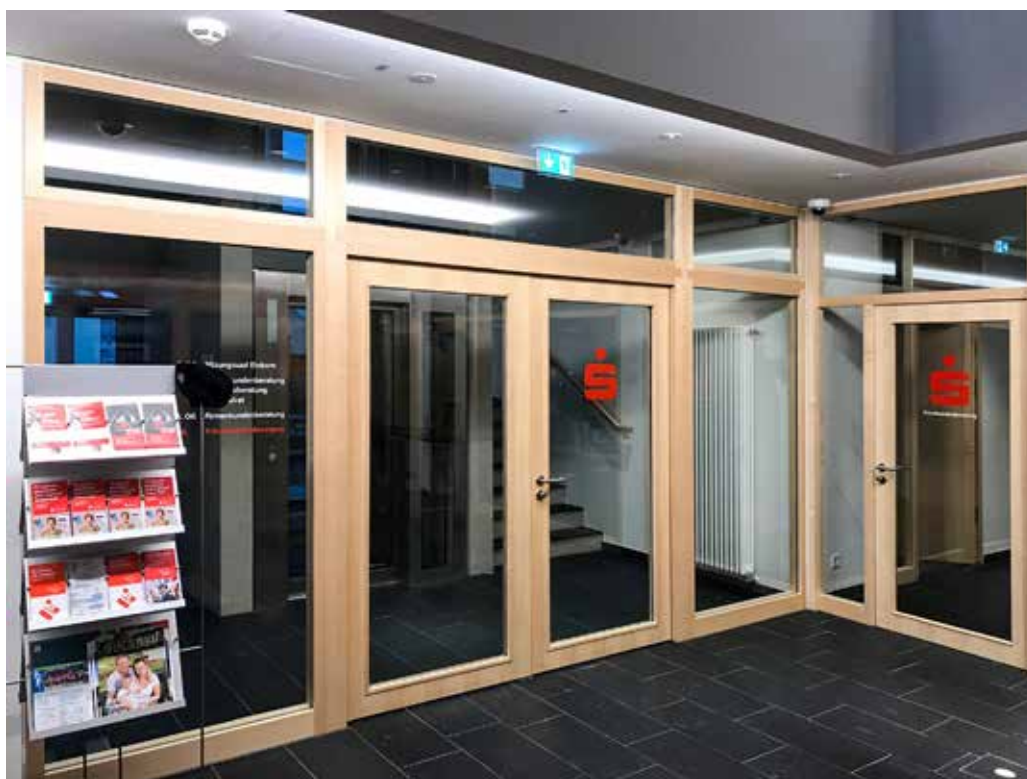
KÖ-PRBILD-TM0002 Foyer: Glaswand mit F30-Brandschutzverglasung.
